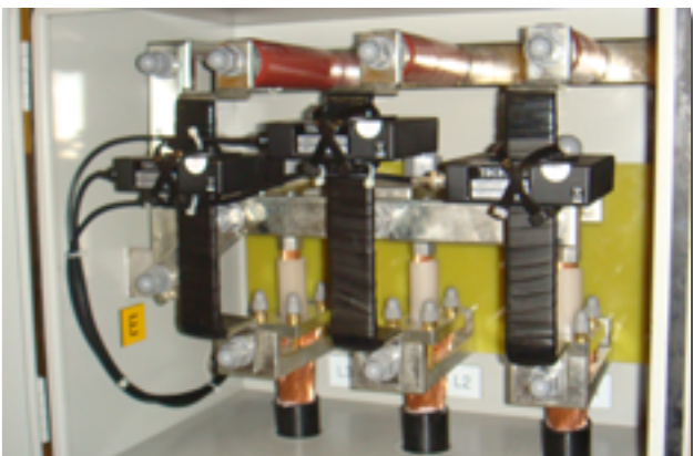
Εγκατάσταση HFCT στους ΤΕΡΜΑΤΙΣΜΟΥΣ ΚΑΛΩΔΙΩΝ, γύρω από τα καλώδια σύνδεσης στο έδαφος μέσα στο πλαίσιο σύνδεσης.
