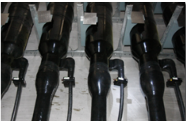
Εγκατάσταση HFCT σε ΤΕΡΜΑΤΙΣΜΟΥΣ ΚΑΛΩΔΙΩΝ, γύρω από τα καλώδια σύνδεσης γείωσης έξω από το πλαίσιο σύνδεσης.
